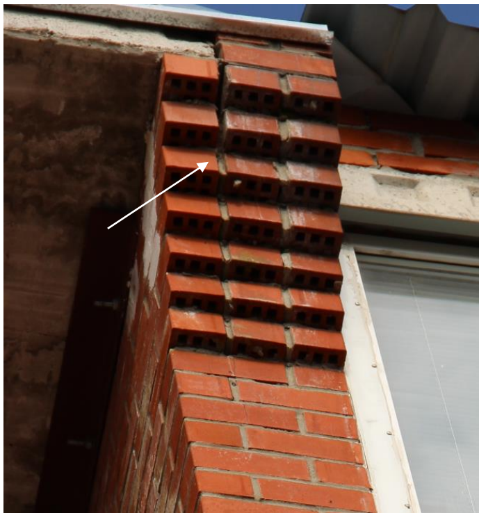
Фото №31. Характерный расклинивающий эффект с расслоением кладки на 8-9 рядов под ж\б плитами козырьков и лоджий в уровне 4-го этажа домов по ул. Магистральная.
