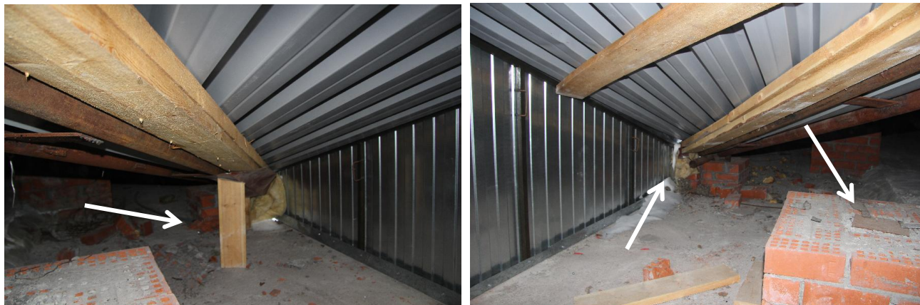
Фото №23,24 .Временные подпорки и снег ( из результатов обследования в феврале 2022г.)
