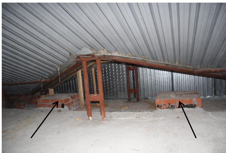
Фото №20. Промежуточные опоры под Р-2 по оси В-В отсутствуют при наличии тумб и закладных.
