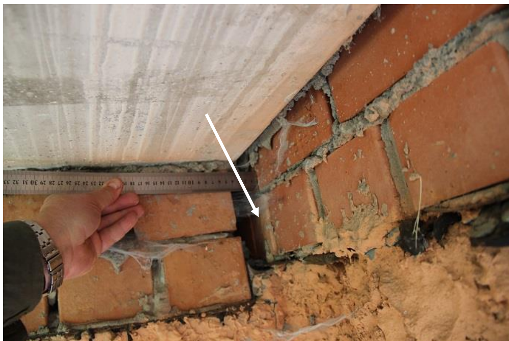
Фото №47. Примыкание стенки лоджии к продольной стене. Стенка лоджии указана стрелкой.
