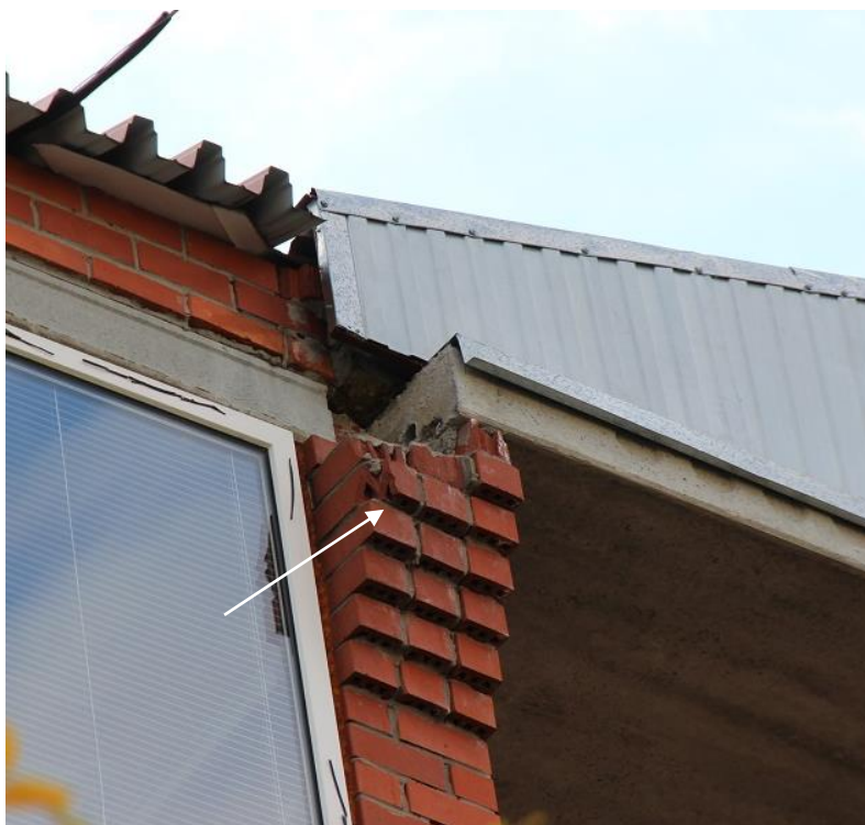
Фото №30. Наиболее разрушенные участки кладки карнизов стенок лоджий домов по ул. Магистральная
