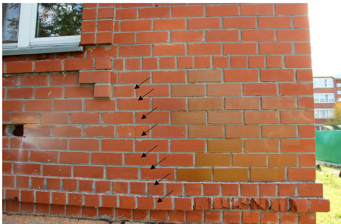
Фото №18. Магистральная 24/1. Трещина через 10 рядов. На выпусках кладки архитектурных элементов полностью отсутствует защита в виде железнённой стяжки.
