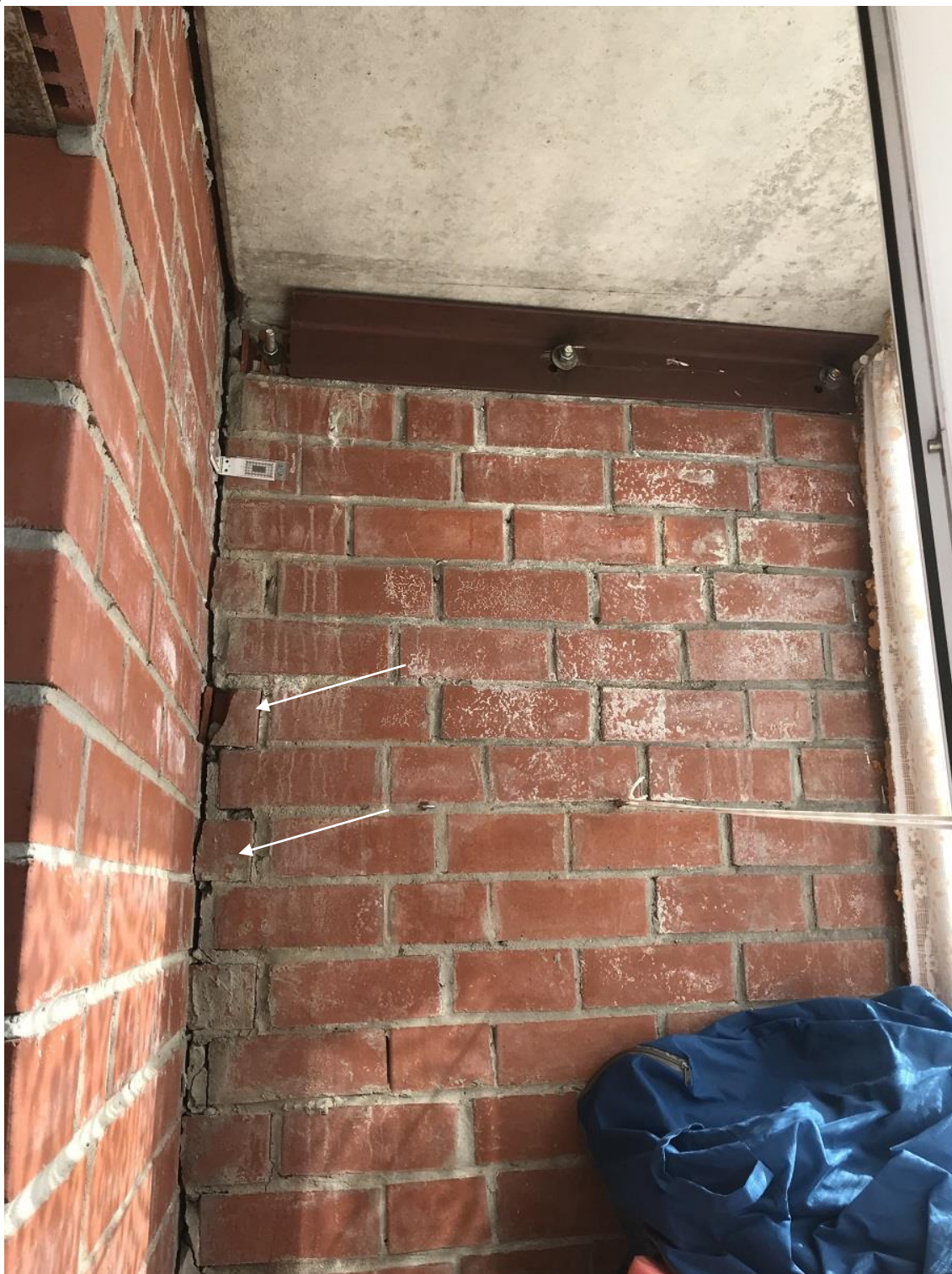
Фото №41. Разрыв камня показан стрелками. Выход из квартиры №27 на лоджию слева. Левая стенка лоджии ( со стороны квартиры)
