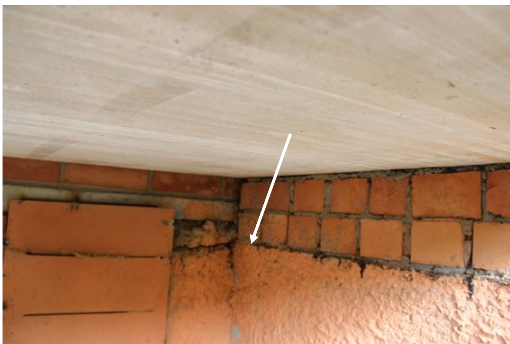
Фото №48. Примыкание стенки лоджии к продольной стене. Стенка лоджии указана стрелкой.
